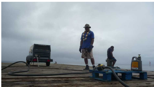
Figure 10 : Compresseur de chantier HP Atlas Copco avec graisseur en ligne - Wharf de Futuna
