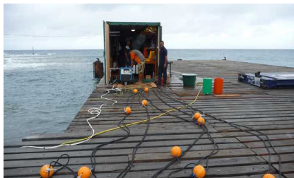
Figure 4 : Câbles de soudage - Wharf de Futuna
