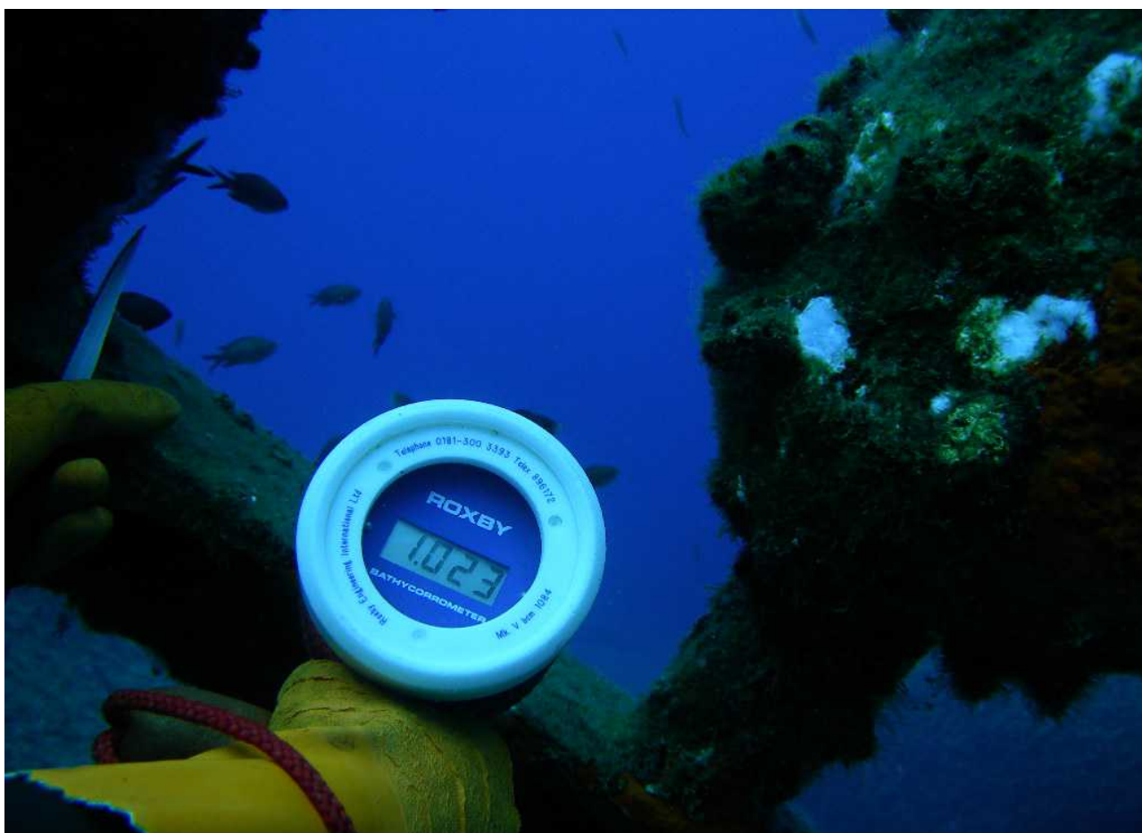
Figure 1 : Relevé du potentiel électrochimique de la tourelle métallique de Perduto Corse du Sud -1023 mV Ag/AgCl/eau de mer
